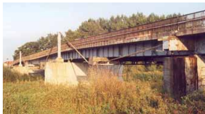
Ryc. 3. Wzmocniony most przez San w Rzuchowie, pierwszy polski most typu extradosed , fot. M. Łagoda
