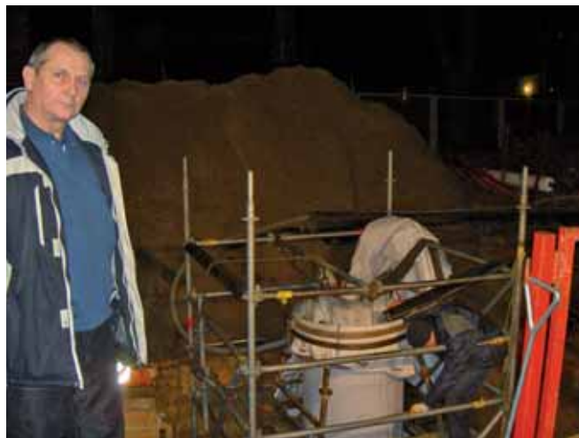
Mimo iż w Zielonej Górze renowacja rękawami to nie pierwsza, zawsze tego typu prace wzbudzają ciekawość i zainteresowanie. Z lewej dyrektor ds. eksploatacji Zbigniew Liberek
