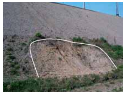
Ryc. 6. Zrekonstruowany nasyp. Zaznaczone widoczne powierzchniowe osuwanie się materiału, fot. Geopartner
