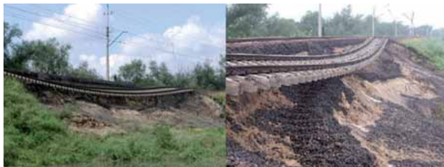
Ryc. 4. Osuwisko w obrębie nasypu kolejowego, fot. Geopartner
