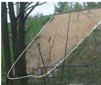
Ryc. 3. Nasyp kolejowy z uzupełnieniem materiału w obrębie powierzchniowego zsuwu ośrodka, fot. Geopartner
