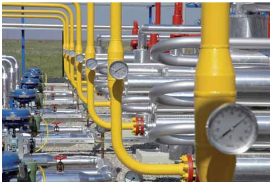
Ośrodek Zbioru Gazu Biszcz – Książpol
