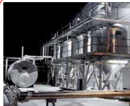
Instalacja odsiarczania gazu ziemnego
