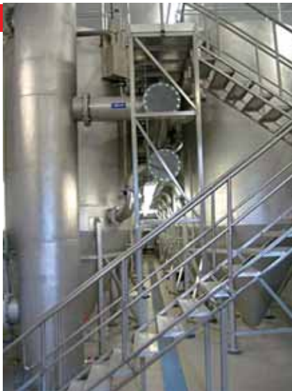
Urządzenia do uzdatniania wody w Otwocku
