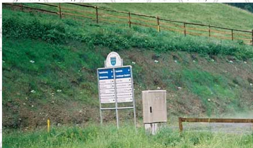
Podcięta skarpa w miejscowości Lierzberg, Austria
