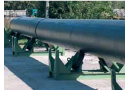
Rys. 7. Prowadnice rolkowe (zdjęcie własne z budowy kolektora kanalizacyjnego w Szczecinie, dzięki uprzejmości firmy JT – Zakład Budowy Gazociągów)
